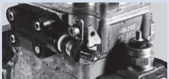
Sérülés az elektromos kábelen (EDC adagolónál)
